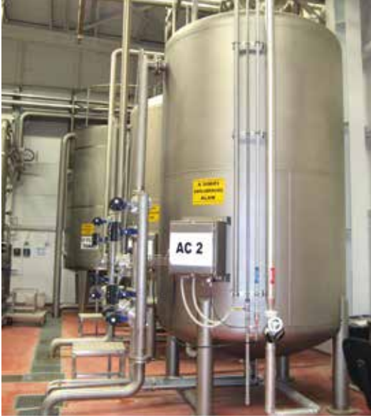
Resim 5. Paslanmaz Çelik Tank ile İmal Edilmiş Aktif Karbon Filtre
